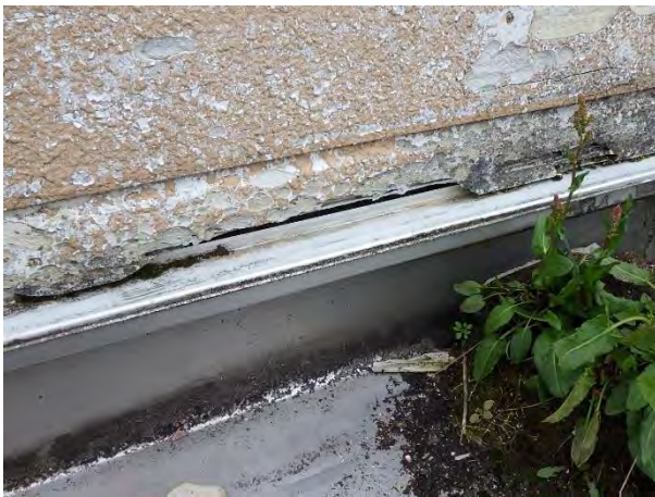
P H階西側（外部） 外壁の剥離が見られる。
