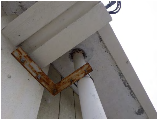
PH階南側（外部） 軒天に塗装の剥離が見られる。 雨樋を支えるL型鉄骨に錆が見られる。
