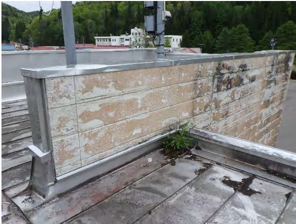
P H階西側（外部） 外壁の塗装に剥離が見られる。 アルミ笠木に陥没が見られる。
