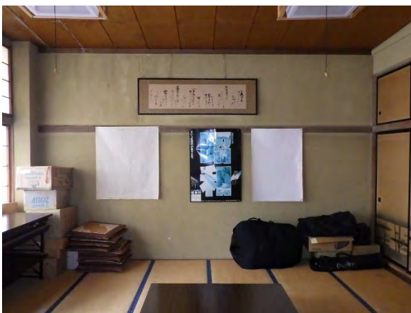
2階和室 壁面にシミが見られる。
