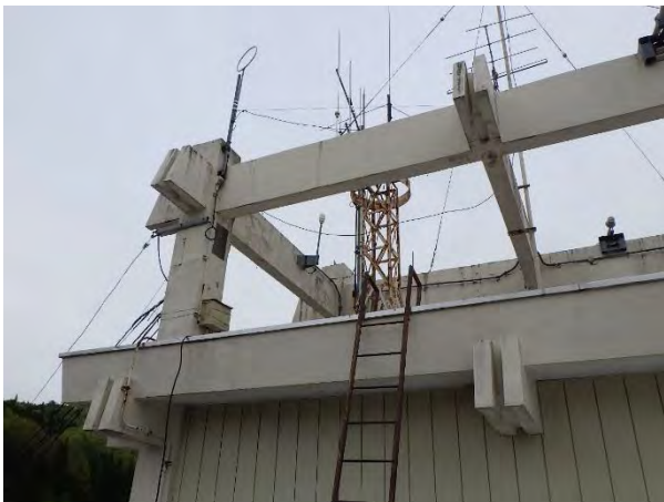
PH階北側（外部） 梁にクラックと塗装の剥離が見られる。
