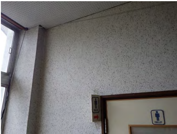
2階トイレ前廊下 壁面にクラックが見られる。
