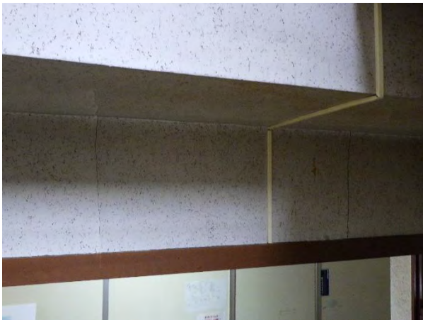
1 階住民係前廊下 下がり壁にクラックが見られる。
