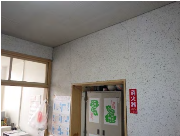
1 階更衣室前廊下 壁面にクラックが見られる。
