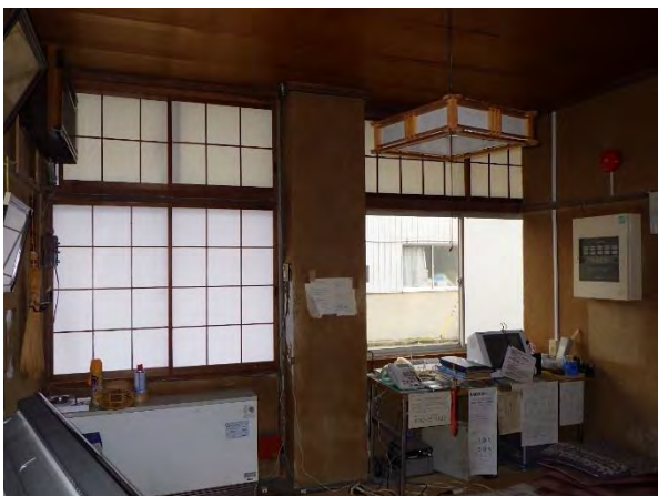
1 階宿直室 壁面の塗装に剥離とシミが見られる。
