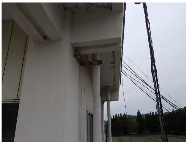
P H階東側（外部） 軒天にクラックと塗装の剥離が見られる。
