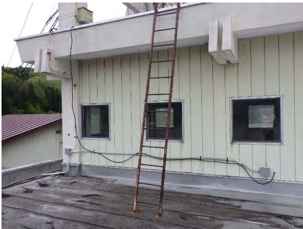
PH階北側（外部） 梁にクラックと塗装の剥離が見られる。 軒天の塗装に剥離が見られる。 屋根面の塗装に剥離が見られる。 梯子に錆が見られる。
