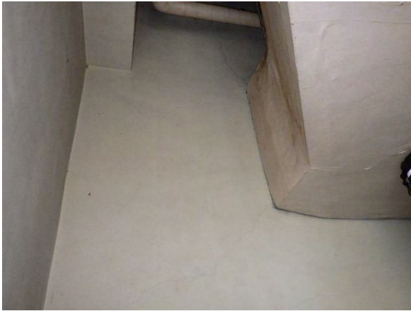
1 階更衣室 壁面にクラックが見られる。
