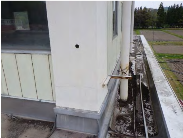
PH階東側（外部） 柱にクラックが見られる。 アルミ笠木に変色が見られる
