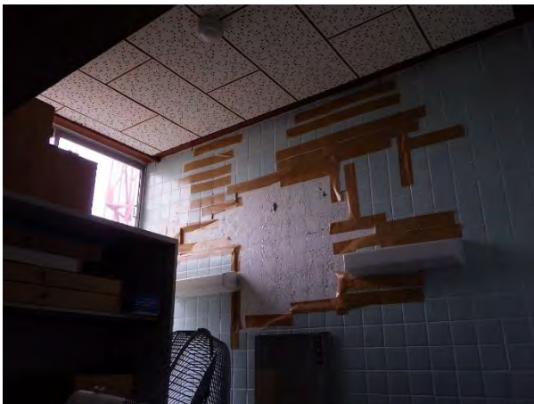
2階化粧室 壁面のタイルに剥離が見られる。 天井にシミが見られる。
