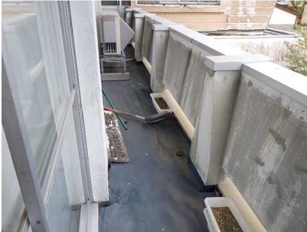
2階西側バルコニー 柱にクラックが見られる。
