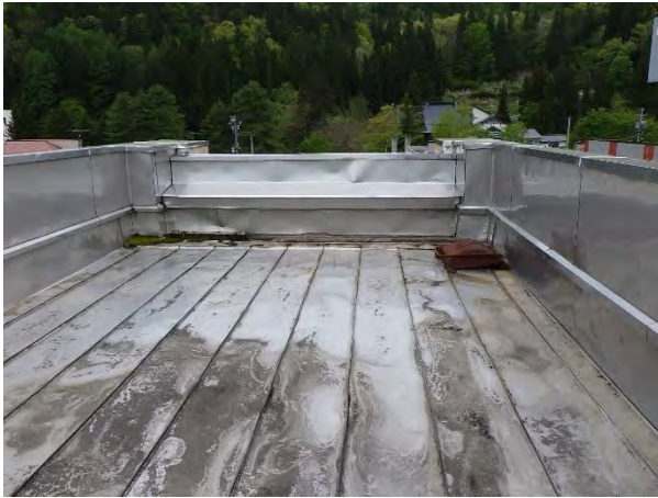
PH階南側（外部） アルミ壁に陥没が見られる。 屋根面に変色が見られる
