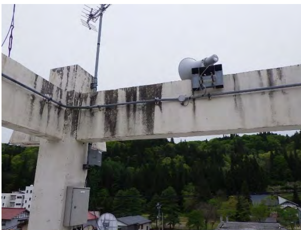
PH階上部南側（外部） 梁にクラックと塗装の剥離が見られる。
