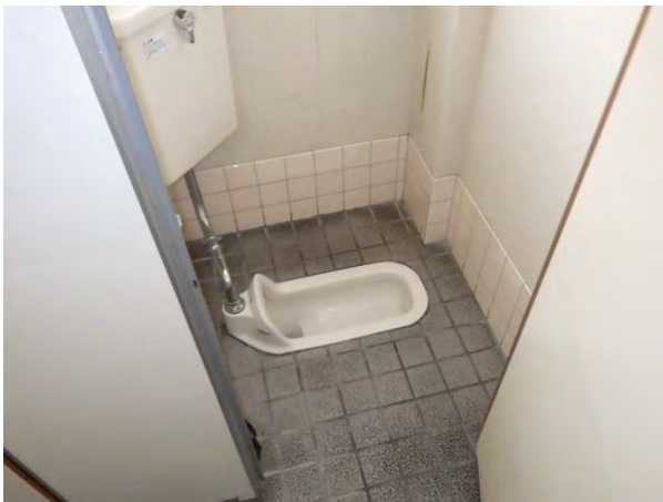
1 階トイレ 壁面のクロスに浮きが見られる。
