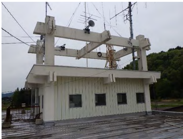
P H階東側（外部） 梁にクラックと塗装の剥離が見られる。
