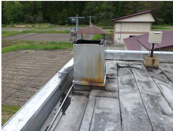
P H階北側（外部） 煙突屋根に錆が見られる。 アルミ笠木に変色が見られる。
