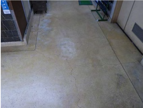
1 階住民係前廊下 床面にクラックが見られる。
