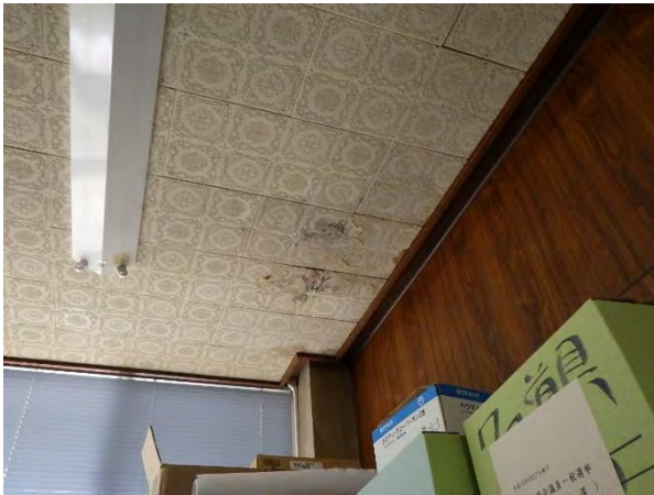
2階選挙管理委員会 天井に浮きとシミが見られる。
