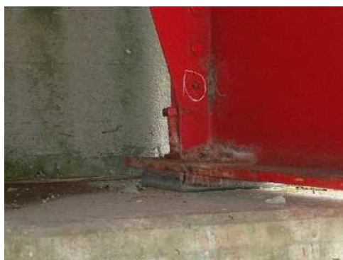
三島橋：アンカーボルトの飛出し
