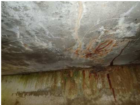
77. 駒止線9号橋：RC床版橋 (橋長：5.86m、1972年竣工) 床版下面の錆汁を伴った遊離石灰・ひびわれ ※内部鉄筋の腐食の進行は、耐荷力の低下 に影響する。(迂回路無)
