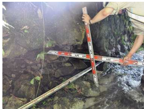
35. 和久入線1号橋：プレテンT桁橋 (橋長：4.26m、1972年竣工) A1橋台前面石積の崩落 ※損傷の進行により、橋台の沈下へと進展 する可能性がある。(迂回路無)
