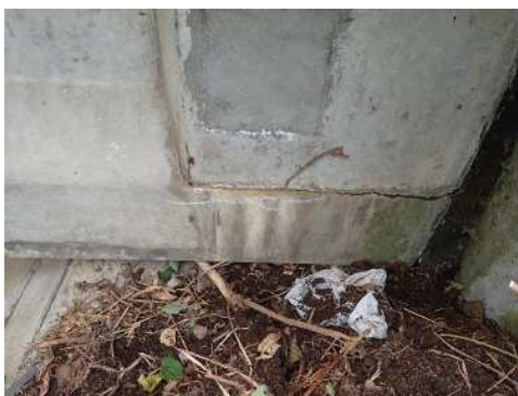
26. 日影橋：プレテンT桁橋 (橋長：17.3m、1978年竣工) 横桁P C定着部の錆汁を伴った遊離石灰 ※横締め鋼材の腐食の進行は、耐荷力の低下 に影響する。(迂回路無)
