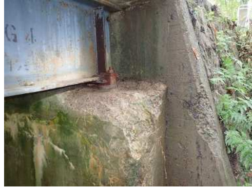
75. 三階橋：鋼H桁橋 (橋長：14.4m、1964年竣工) 下部工の遊離石灰を伴った微細なひびわれ 及び剥離、欠損 ※凍結融解の繰返しにより、主桁の脱落へ と進展する可能性がある。(迂回路無)
