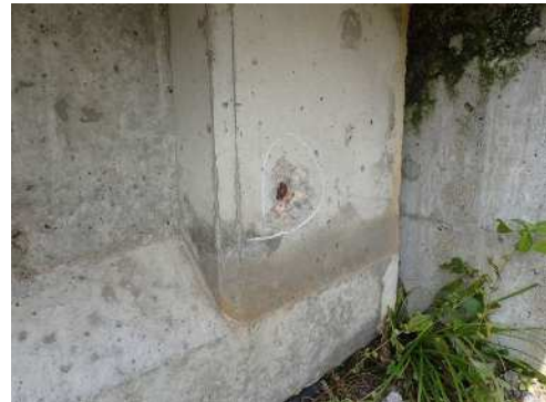
29. 八反田橋：プレテンT桁橋 (橋長：16.10m、1984年竣工) 横桁P C定着部横締め鋼材の露出 ※横締め鋼材の腐食の進行は、耐荷力の低下 に影響する。(迂回路有)
