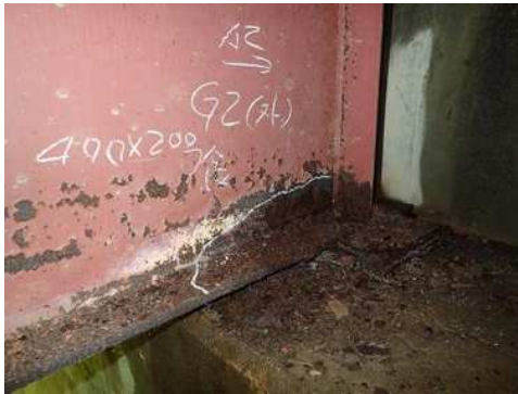
64. 田島線3号橋：鋼H桁橋 (橋長：8.5m、1972年竣工) 主桁端部の板厚減少を伴った腐食 ※支点上での板厚減少により耐荷力の低下 が推測される。(迂回路有)
