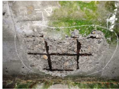
83. 駒止線3号橋：RC床版橋 (橋長：4.3m、1972年竣工) 床版下面の露出鉄筋の著しい腐食 ※露出鉄筋の著しい腐食により、耐荷力の 低下が推測される。(迂回路無)
