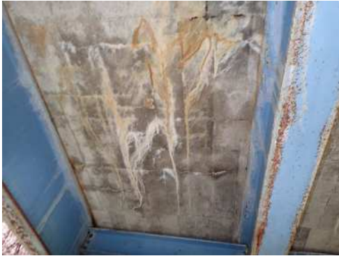
74. おいと橋：鋼H桁橋 (橋長：12.4m、1965年竣工) 床版下面の錆汁を伴ったひびわれ ※内部鉄筋の腐食の進行は、耐荷力の低下 に影響する。(迂回路無)
