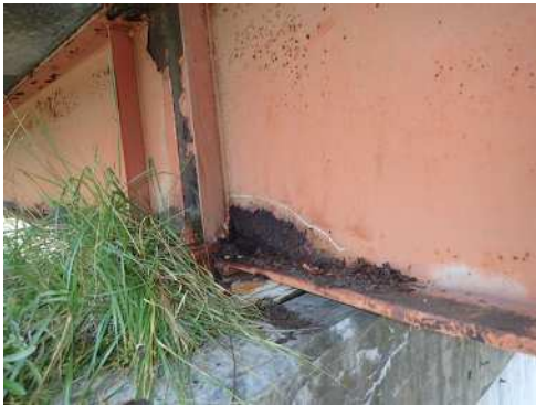
06. 沢口橋：鋼H桁橋 (橋長：47.5m、1964年竣工) 主桁端部の板厚減少を伴った腐食 ※支点上での板厚減少により耐荷力の低下 が推測される。(迂回路有)
