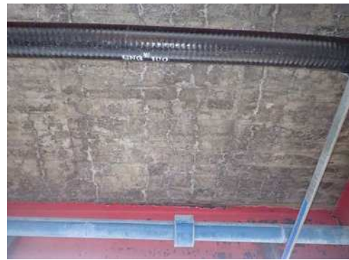
07. 新田橋：鋼H桁橋 (橋長：42.6m、1970年竣工) 床版下面の遊離石灰を伴った二方向ひびわれ ※雨水の浸入により進行する可能性がある。 (迂回路有)
