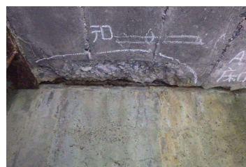
床版の鉄筋露出
