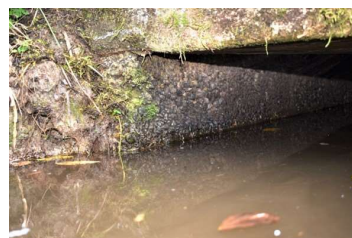
A2橋台の欠損(浸食)
