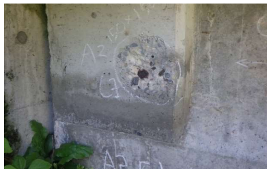
端横桁定着部の横締め鋼材露出
