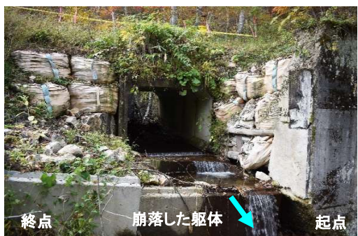
橋梁左側(下流側躯体崩落後、根固として応急利用)
