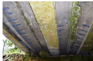
桁下面終点側(未補修)
