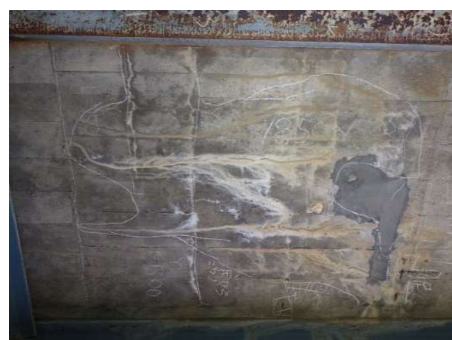
床版下面の錆汁・遊離石灰を伴う二方向ひびわれ
