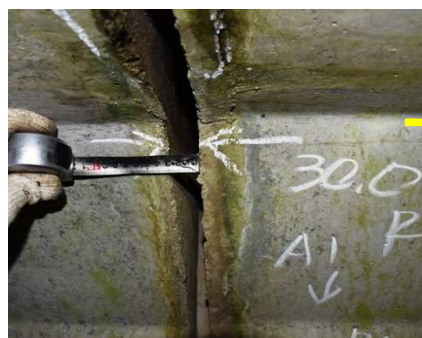
頂版目地部の移動による隙間
