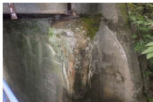
A1橋台の遊離石灰を伴うひびわれ、剥離、うき、欠損
