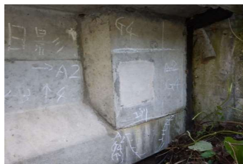
端横桁定着部の遊離石灰の析出
