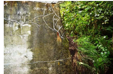
A2橋台ひびわれ、遊離石灰、うき、欠損
